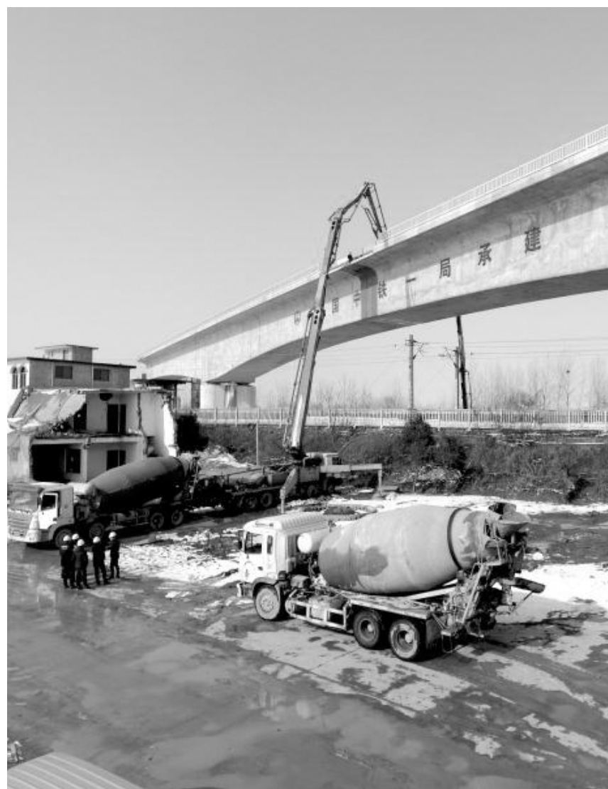
1月30日13时10分,郑(州)合(肥)高铁沈丘段沈界1号特大桥跨漯阜铁路转体连续梁中跨合龙段顺利浇筑完成。图为施工现场。
