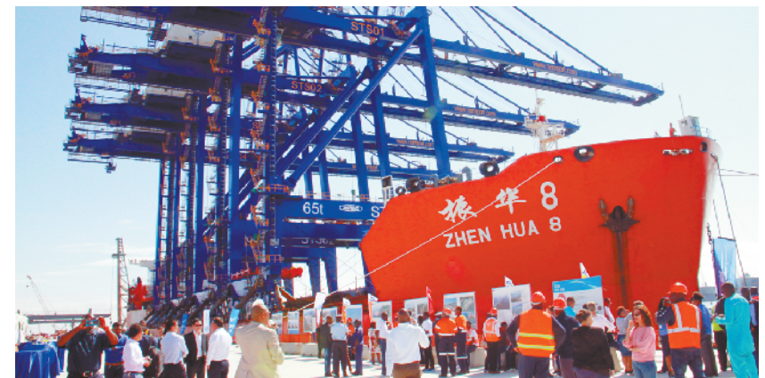
纳米比亚沃尔维斯湾码头岸桥到港 2月9日,运载着四台岸桥的货轮停靠在纳米比亚沃尔维斯湾正在建设的集装箱码头。载着四台巨大岸桥的货轮9日上午缓缓靠向正在建设的纳米比亚沃尔维斯湾集装箱码头。这四台岸桥由中国上海振华重工(集团)股份有限公司制造。已于2014年5月开工沃尔维斯湾集装箱码头扩建项目由中国港湾公司承建,项目合同额逾3亿美元。新华社记者 吴长伟摄
