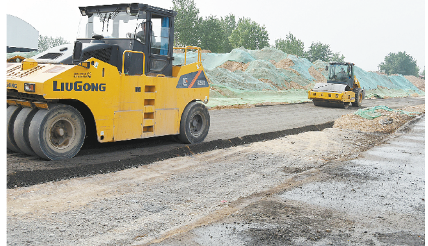
开发区认真办理民生实事,图为朝阳路南通项目正在进行路基铺设。②8 曹文娟 摄
