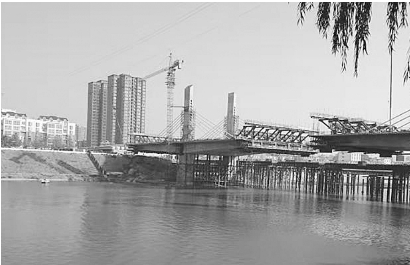
沈丘县沙河大桥项目是沙颍河周口至省界航道升级改造重点工程。大桥全长1.24km,主桥为双塔双索面部分斜拉桥。截至11月26日,该项目已完成投资1.48亿元,占项目总投资的92%,预计2019年1月建成通车。图为建设现场。高翔成 摄
