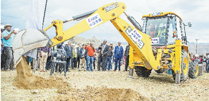
12月6日,在莱索托哈姆皮蒂,莱索托首相塔巴内(车内右)在工作人员的指导下驾驶挖掘机,为工程铲出第一铲土。中国援助莱索托道路升级项目6日正式开工。这是中非合作论坛北京峰会后首个在非洲落地的大型双边务实合作项目。新华社发
