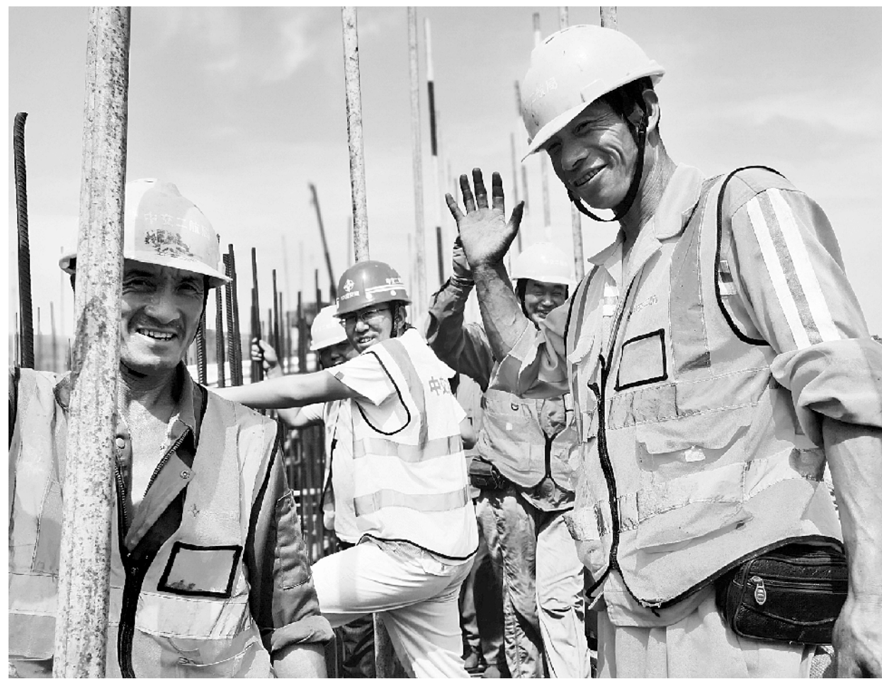
8月19日,骄阳似火、热浪灼人,地表温度接近40℃。然而,在由中交二航局承建的沈丘沙颍河航道升级改造工程施工现场,始终活跃着一支党员队伍,他们引领建设者们,发扬“铁军”精神,战高温、赶工期,接受大“烤”。 沙颍河航道升级改造项目是河南省重点工程,也是周口市发展临港经济的重点项目沙颍河周口至省界航道升级改造工程PPP项目。 记者 孙安平 通讯员王向灵 郭欣然 摄
