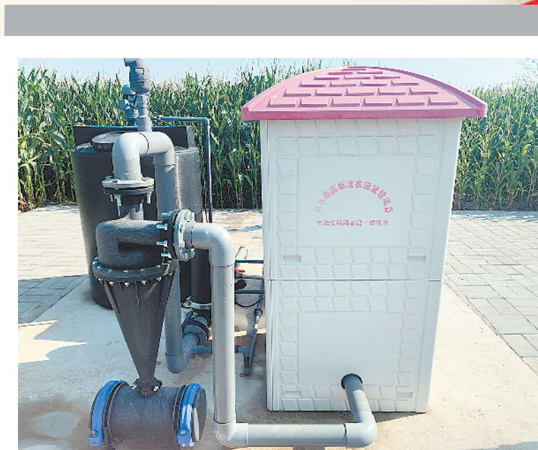
“水肥一体化”灌溉设施
