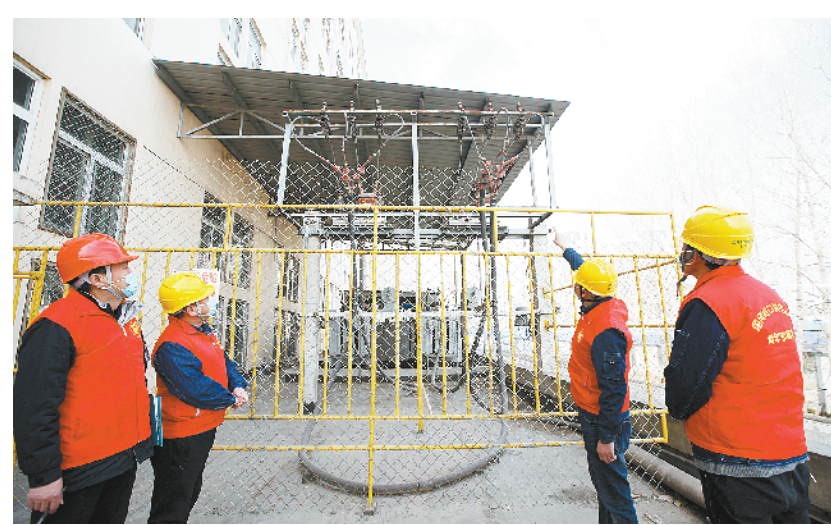
国网周口供电公司工作人员到企业为供电设备“体检”
