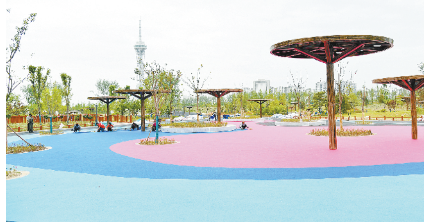
4月28日,周口沙颍河湿地公园内工人正在游乐场铺设七彩塑胶地面。据施工人员介绍,铺设塑胶地面要20多天时间,为了保证施工质量,希望市民在施工期间不要进入施工现场。记者 孙安平 摄
