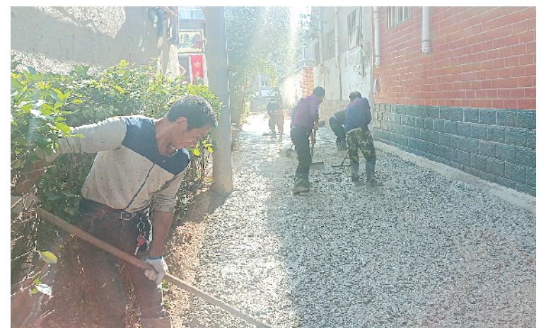
“创文”工作开展以来,川汇区坚持创建为民、创建惠民,聚焦路不平、灯不明、水不畅等群众关心的民生问题,划分片区、限时整改、全域提升,促进城市全面发展。图为金海路街道办事处背街小巷改造现场。
