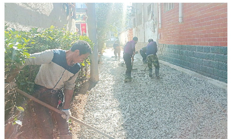
“创文”工作开展以来,川汇区坚持创建为民、创建惠民,聚焦路不平、灯不明、水不畅等群众关心的民生问题,划分片区、限时整改、全域提升,促进城市全面发展。图为金海路街道办事处背街小巷改造现场。记者 韩志刚 摄
