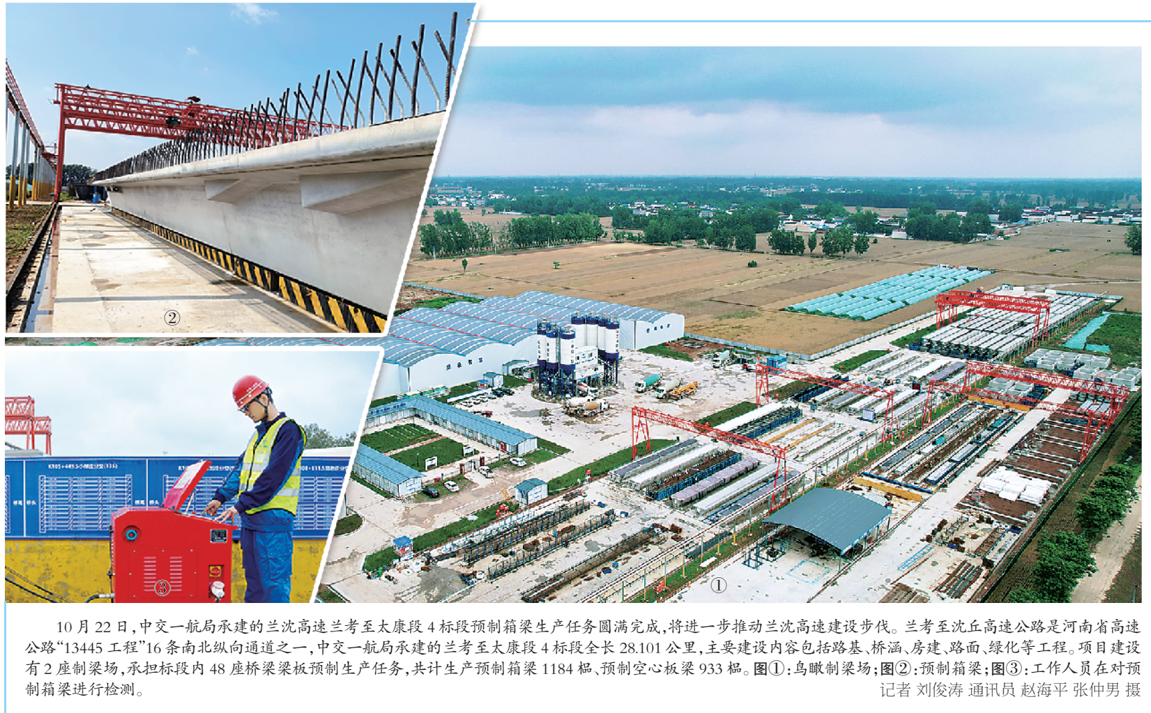
10月22日,中交一航局承建的兰沈高速兰考至太康段4标段预制箱梁生产任务圆满完成...
