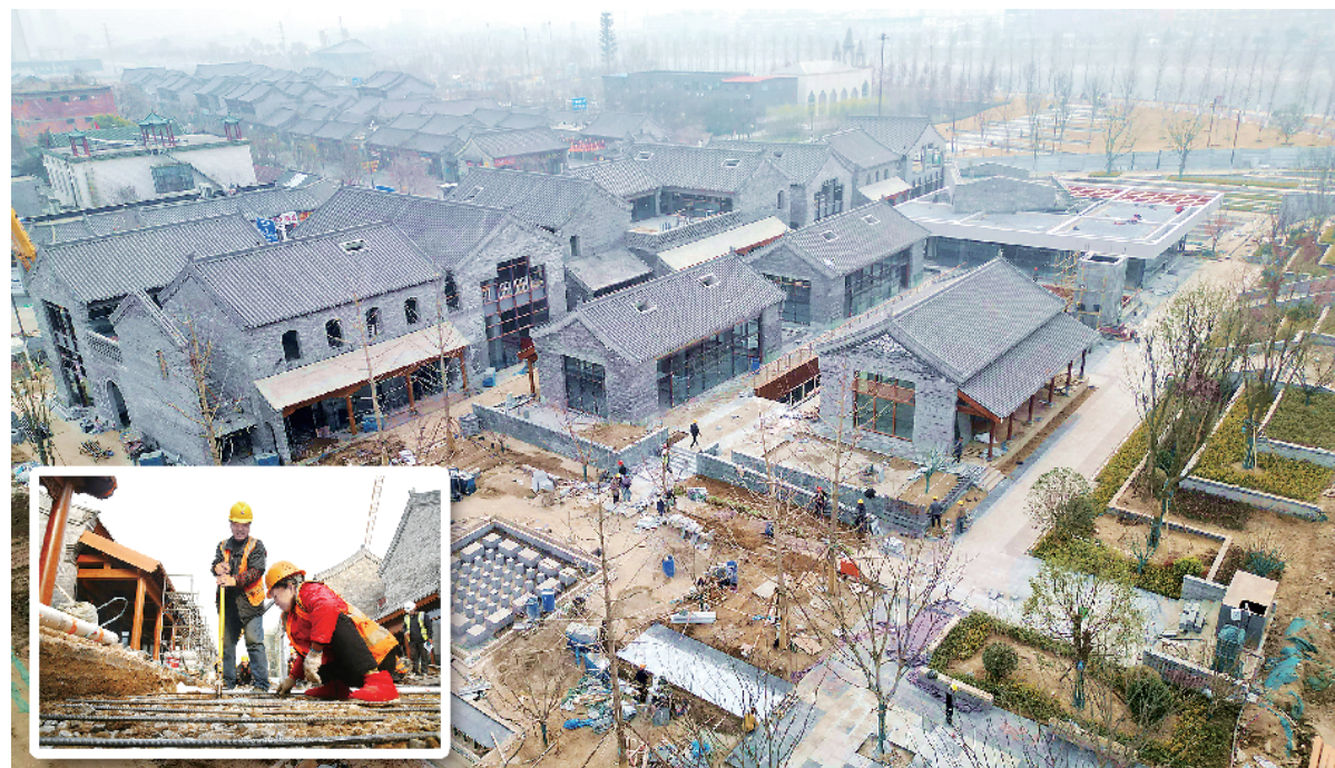
1月14日上午，中建七局施工人员正加紧推进三川十馆项目庭院道路、廊檐等附属工程建设。据介绍，该项目的定位是集文化、商业于一体的沉浸式文化街区，兼具体验感与互动感。按照计划，项目中的商业街区及会馆公园将于春节前完工。
