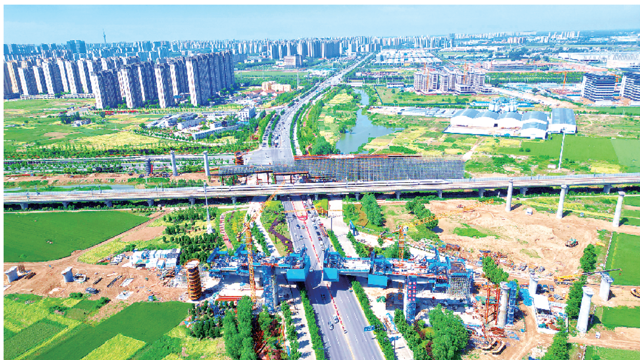
5月12日上午，一高速列车从位于周口中心城区的平漯周高铁建设工地驶过。平漯周高铁建成后，将成为河南省“米”字形高铁网的重要组成部分。 记者 梁照曾 摄
