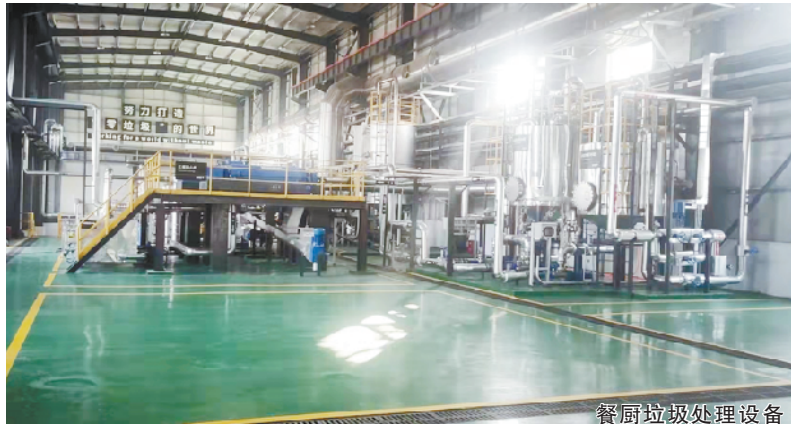
餐厨垃圾处理设备
