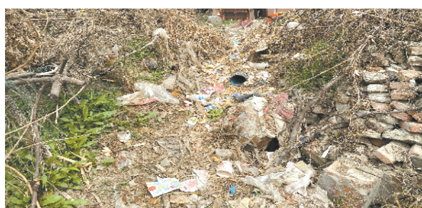
郸城县巴集乡巴楼村村村庄周边坑塘边坡存在堆放大量杂物和生活垃圾现象
