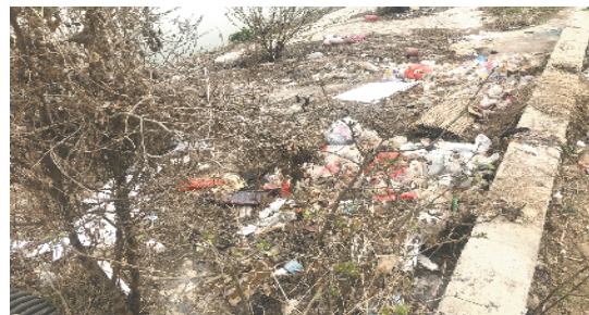
项城市光武街道办事处 102 省道沿线南顿古城东侧沟渠边坡存在多处生活垃圾堆积现象
