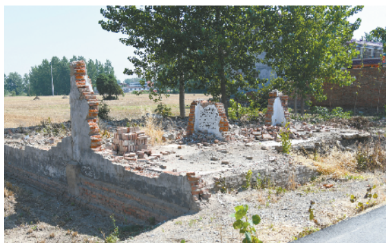
项城市范集乡文庄村东 026 线道两侧多处残垣断壁,并有建筑垃圾堆放
