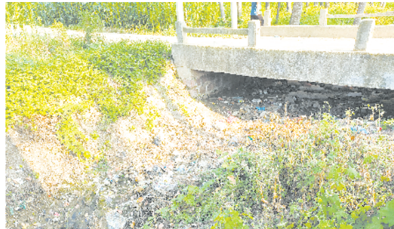
郸城县白马镇郭路口村桥下存在大量陈年生活垃圾
