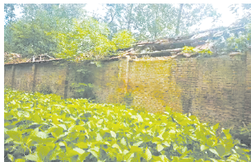
郸城县钱店镇钱店村村东有一排残垣断壁
