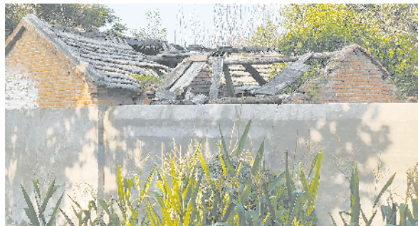
郸城县白马镇张小庙村东侧两间民房摇摇欲坠
