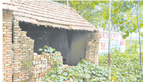
鹿邑县太清宫镇薛屯寨村段存在残垣断壁及墙体大面积“牛皮癣”
