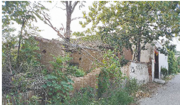
周口港区李埠口办事处高山顶村内存在危房摇摇欲坠
