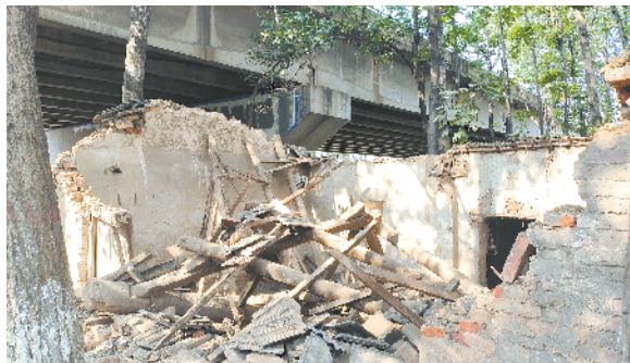
淮阳区朱集乡境内宁洛高速与 106 国道交叉口北侧存在危房一座
