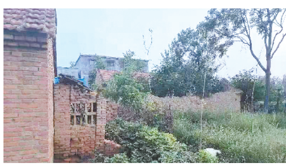
川汇区城南办事处中村村西南角存在建筑废墟
