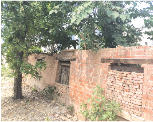
项城市千佛阁办事处狮子李营村南侧有一座残垣断壁院子,需整改
