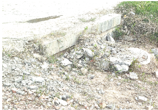
淮阳区 018 县道淮阳农场东侧,桥体有建筑垃圾堵塞
