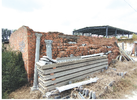
淮阳区 018 县道淮阳农场小学北路东侧有一处破旧停工房屋,需整改
