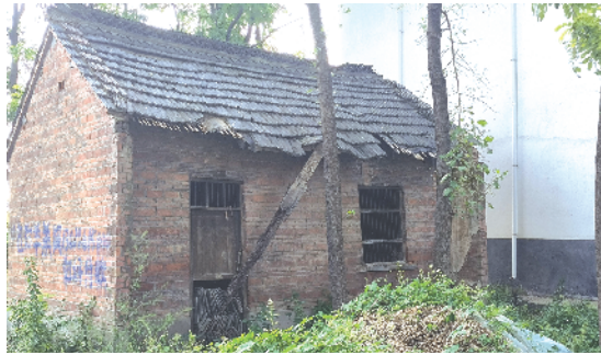
沈丘县洪山镇贾庄村东侧有破旧危房,需整改
