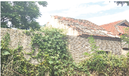
黄泛区实业集团农兴路西侧存有残垣断壁建筑,需整改
