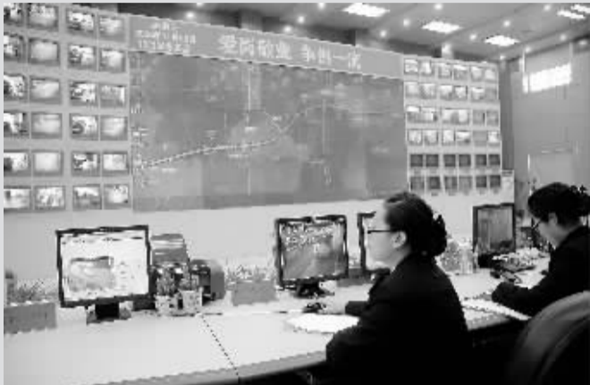
河南高速周口分公司现代化监控中心。
