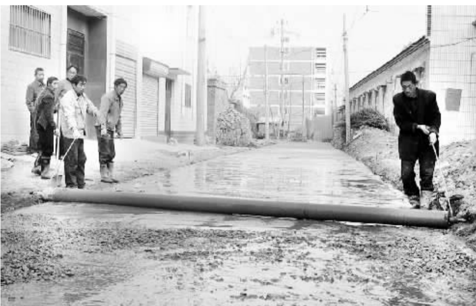
昨日,施工人员正在川汇区李庄街铺设混凝土。据了解,再过半月,这条长398米的民心路即可全面改造完毕。截至目前,川汇区已硬化改造中心城区小街小巷338条,硬化面积18万多平方米。
