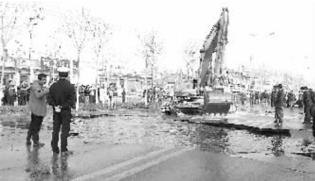
陕西宝鸡市冯家山输水管道第 11 次爆管 12月16日,挖掘队在爆管现场抢险。当日中午,担负陕西宝鸡市 70%人口供水的冯家山输水管道在宝鸡市陈仓大道育才专修学院附近发生爆管,这是该工程自 1998 年试供水以来发生的第 11 次爆管,也是今年 12 月发生的第三次爆管,造成宝鸡市城区大面积停水。 新华社发
