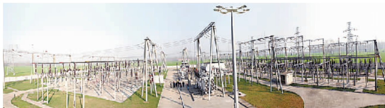
220千伏水寨变电站
