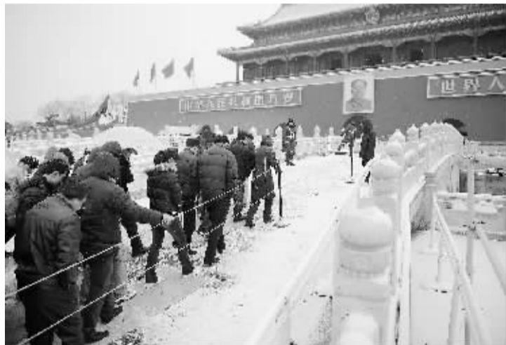
天安门金水桥今起加固修缮 2月18日,游客从尚未封闭的天安门金水桥东侧通过。为迎接新中国成立60周年,天安门管委会从当日起对金水桥实施保护修缮,工程拟于2009年5月1日前完工,并整体对外开放。 新华社记者 罗晓光 摄
