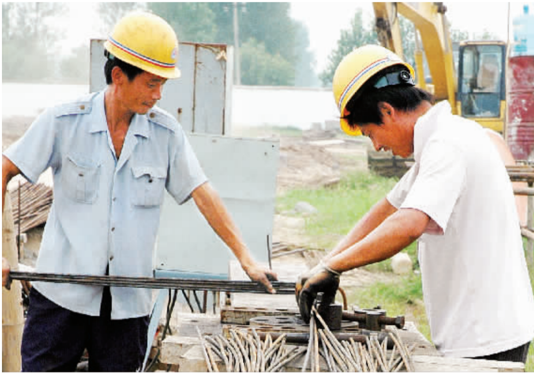
连日来,奋战在全市各重点工程工地上施工单位的广大职工战高温、冒酷暑,按照质量目标和进度计划进行紧张施工。(记者 沈湛摄)
