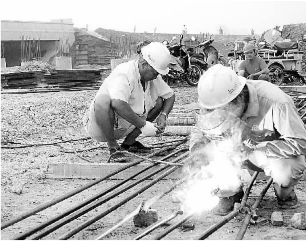
昨日,在周口大道施工段贾鲁河东干渠桥面加宽工地上,工人们正在加班加点工作着。北环路至高速周口北站施工线上一派繁忙景象,工程进展顺利。(记者 沈湛 摄)
