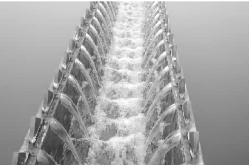
二水厂平流沉淀池
