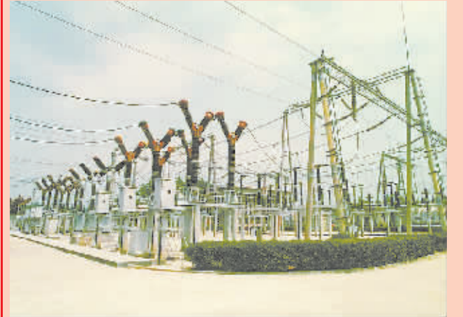
周口第一座 220 千伏淮阳变电站 (张宝云摄)
