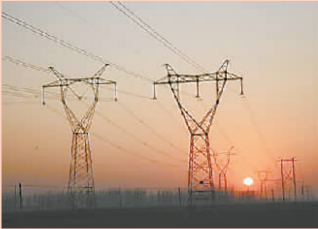
220 千伏邵川输电线路和 200 千伏邵淮输电线路
