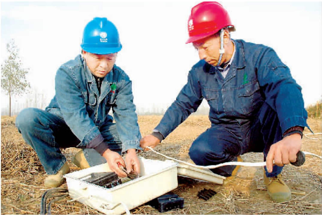
为确保扶沟县工业园区项目用电需求,扶沟供电公司积极落实园区供电线路勘测设计,开辟用电绿色通道,为工业项目落户园区作出了重要贡献。图为该公司工作人员在工业园区内检查漏电保护器。(记者 李寒 摄)
