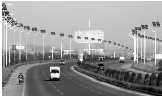
1月25日,汽车行驶在安装了太阳能路灯的锦州市渤海大道上。日前,安装在辽宁省锦州市渤海大道两旁的太阳能路灯正式投入使用。据悉,这些由1512块太阳能电池组件组成的太阳能路灯,每天可节电637度。新华社发(李铁成 摄)
