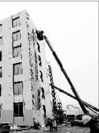
上海世博会远观馆:未来可持续建筑发展方向 在上海世博会浦西片区,一座6层楼房的短短几天之内拔地而起。这座世博会远观馆的主体建筑,不仅创造了世博会场馆快速建设的纪录,也成为对将来可持续建筑的一次探索和尝试。这座建筑的结构、墙体、门窗、电气、空调、照明、给排水等工程都是在工厂里制造完成的,只需在现场进行“组装”。
