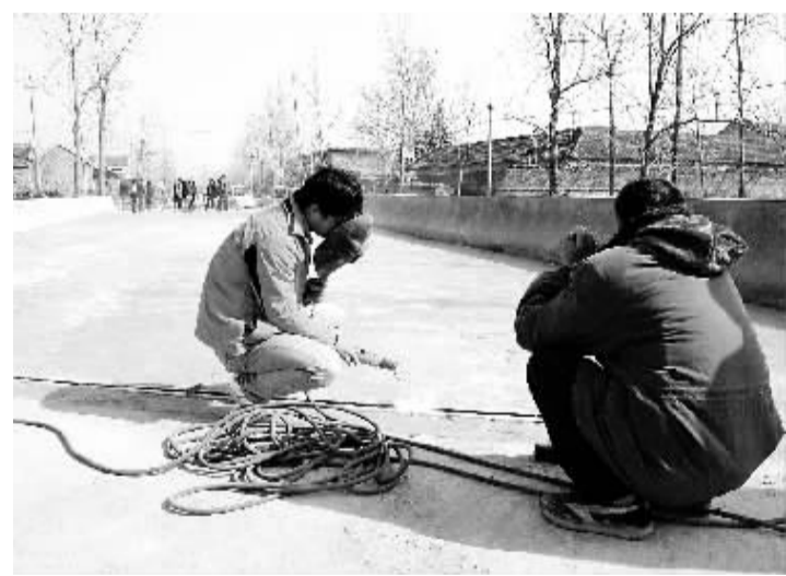
市区园艺场中桥原为一座年久失修的危桥,近日经过有关部门规划设计施工,一座高标准桥梁将投入使用。图为两名施工人员对桥面进行最后处理。(记者沈湛 摄)
