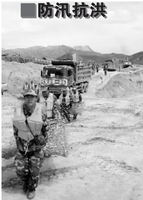
青海格尔木温泉水库抗洪抢险工作紧张进行 7月10日，武警官兵在格尔木温泉水库参加抢险工作。由于频繁强降雨，位于格尔木上游的温泉水库蓄水量超过警戒水位。连日来，3000名武警官兵在格尔木温泉水库大坝的险工险段全力抗洪抢险，防汛抗洪各项工作正在有序、有效开展。专家认为，目前温泉水库各项指标均在可控范围之内，水库坝体仍是稳定的、安全的。
