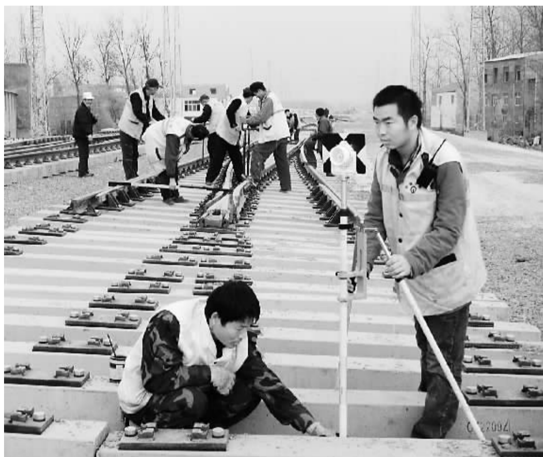
12月3日,阜南铁路周口新站建设工程正在紧张施工。据悉,周口新站移站工程总投资6.3亿元,动用土方75万立方,设计道岔55组,建成使用后将成为阜南铁路线上最大的车站。(记者 田维国摄)
