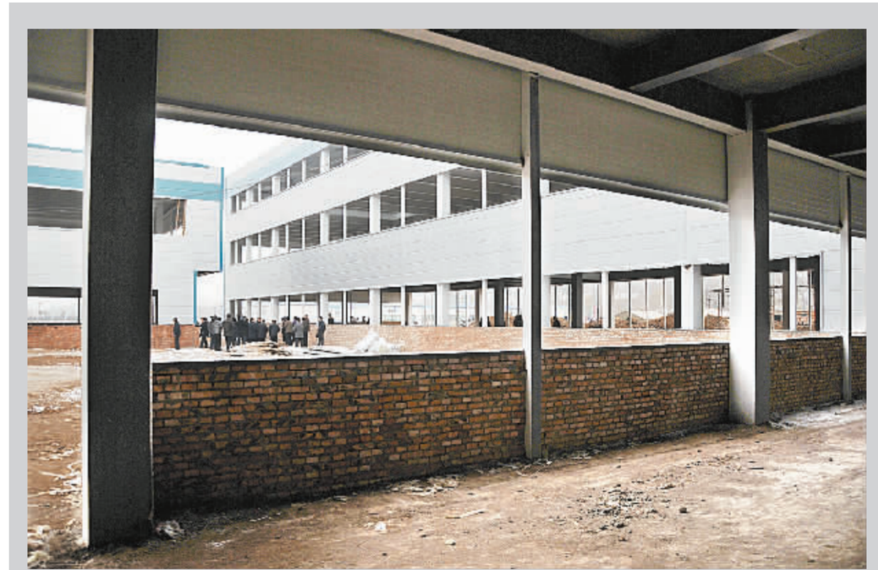
辅仁药业集团总部基地制剂生产中心建设项目总投资5亿元,占地400亩,建筑面积13万平方米。该项目建成后可年产口服液150亿粒(片),实现产值20亿元,带动4000人就业,一期工程已完成投资2.5亿元。
