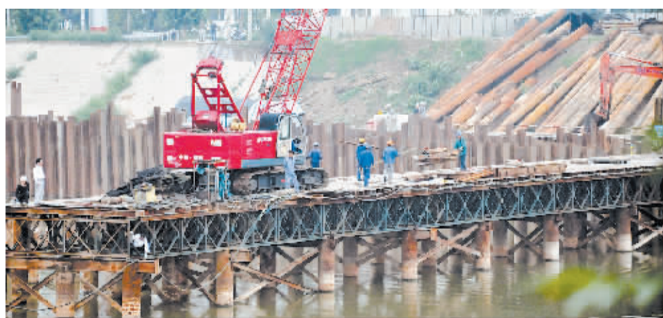
昨日上午,记者在八一路桥施工现场看到,工人们正在紧张施工。据悉,为不影响汛情,工人们已经开始拆除河道中间的便桥,以保证出现洪峰后排水畅通。目前,八一路桥的桥墩已经建好,就是在汛期时,工人们仍然可以正常施工。
