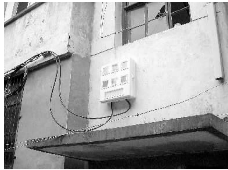
9月21日《周口日报》B1版刊发了题为《电表乱如蜂窝》的新闻图片,鹿邑县电业局领导看到后非常重视,立即安排辖区负责人认真处理解决,电业人员加班加点对稿件反映的配电盘上的14块电表重新进行了安装改造,使用户满意。图为安装改造后的配电盘。侯钦民摄
