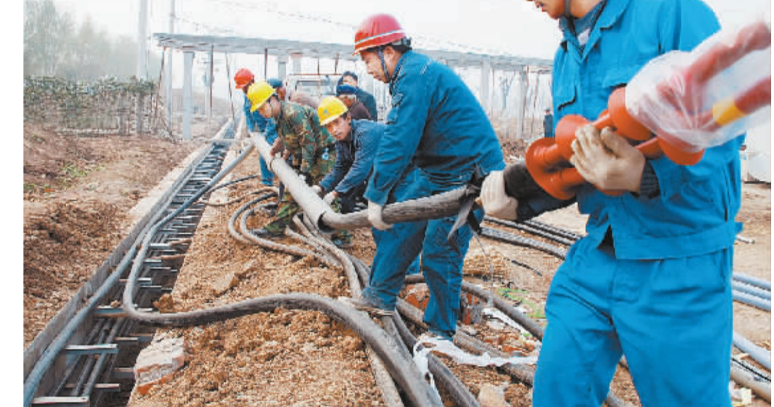
沈丘县电业局积极备战冬季用电负荷高峰,11月26日至28日,连续奋战三天,完成对35千伏“肖东线”和“肖西线”的改造,提高了县城35千伏东关变电站和西关变电站的供电可靠性,提升了县城供电质量。图为11月27日工作人员架设高压电缆的场景。(赵腾明 摄)
