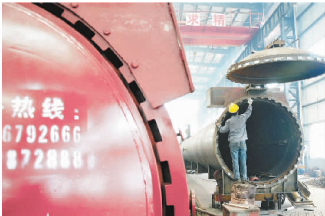
太康县以工业经济和产业集聚区建设为切入点,以招商引资项目建设为突破口,今年前 3 个季度,全县完成生产总值 78.5 亿元,同比增长 10.5%;规模以上工业完成增加值 12 亿元,同比增长 16.2%,取得了良好的经济效益和社会效益。图为该县产业集聚区内一名锅炉技工在一线认真工作。(记者 沈湛摄)
