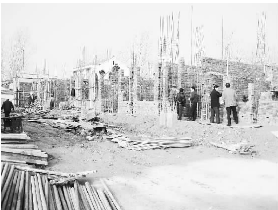
城北办事处徐营学校教学用房改造项目建设正在进行,项目建成后将大大缓解城区学校“大班额”的压力。
