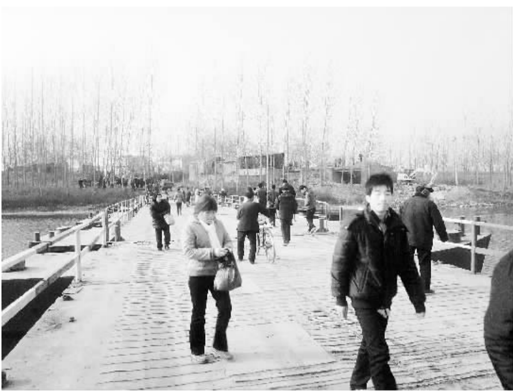
12月27日,项城市交通局经过紧张施工,在被运沙货车压塌桥梁的汾河桥原址附近,新建一座浮桥,解决了当地群众的出行问题。 记者 杨光林 通讯员 田永锋 摄
