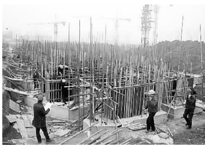
2 月 15 日,项城市湖滨路保障性安居工程(惠民小区)建设项目工地上一派繁忙景象。该项目总投资 1.6 亿元,占地 87.2 亩,建成后可提供经济适用房 10 万多平方米、廉租房 6 万多平方米。(赵献伟 摄)
