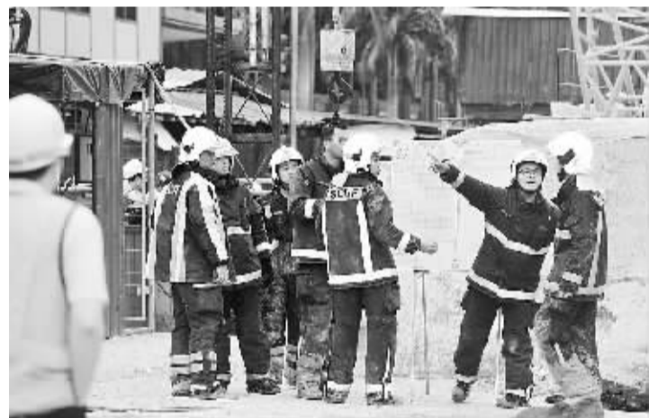
新加坡在建地铁工地发生坍塌事故 7月18日, 救护人员在新加坡武吉士地铁隧道工地进行抢救工作。当日, 新加坡武吉士地铁工地发生坍塌, 导致两名工人死亡。 新华社发
