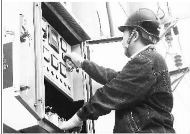
“双节”来临之际,扶沟县供电公司组织员工对全县供用电设备进行全面检修和维护,确保“双节”期间设备安全稳定运行。图为该公司员工在大李庄乡冯老台区察看电表电压运行情况。(袁红梅 摄)
