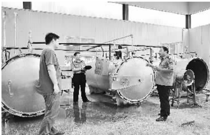
近日来,随着我市“质量月”活动的开展,市质监局对工厂进行质量检验。图为市质监局特检人员对某食品厂锅炉进行检验。(记者 王亚辉 摄)
