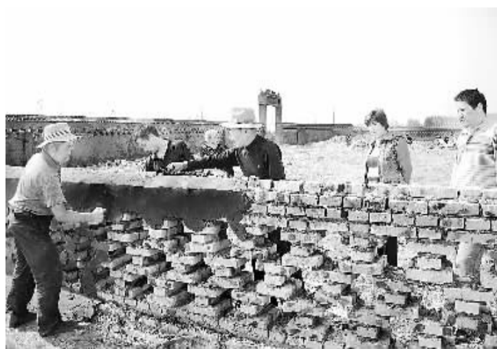
鹿邑县认真落实殡葬改革政策,县乡村三级集中人力、物力、财力积极开展了村级公墓建设,全县358个村级公墓在本月30日前将全部竣工。图为该县大清官镇大清办事处村级公墓施工正在收尾。(李景来 蒋保庆 摄)
