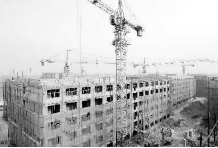
图为鹿邑县产业集聚区公共租赁住房项目建筑施工现场。鹿邑县委、县政府重视产业集聚区配套建设,今年年初开始建设2450套公共租赁住房,解决入驻企业职工住房难题。(记者 杜少华摄)
